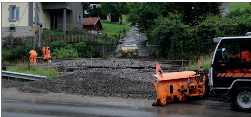
Oberhalb des Sumpf-Quartiers wurden Ende Juli 2021 nach heftigen Niederschlägen die Bahngleise verschüttet. Foto: «FS»-Archiv
